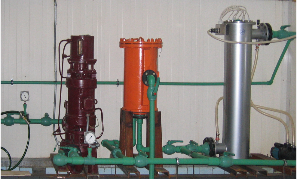
Рис. 6.1. Установка механической очистки и УФ-обеззараживания морской воды
